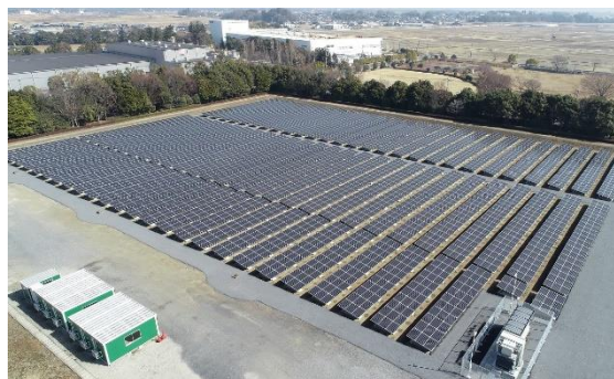
館林工場の太陽光発電設備（約 1.3MW）
